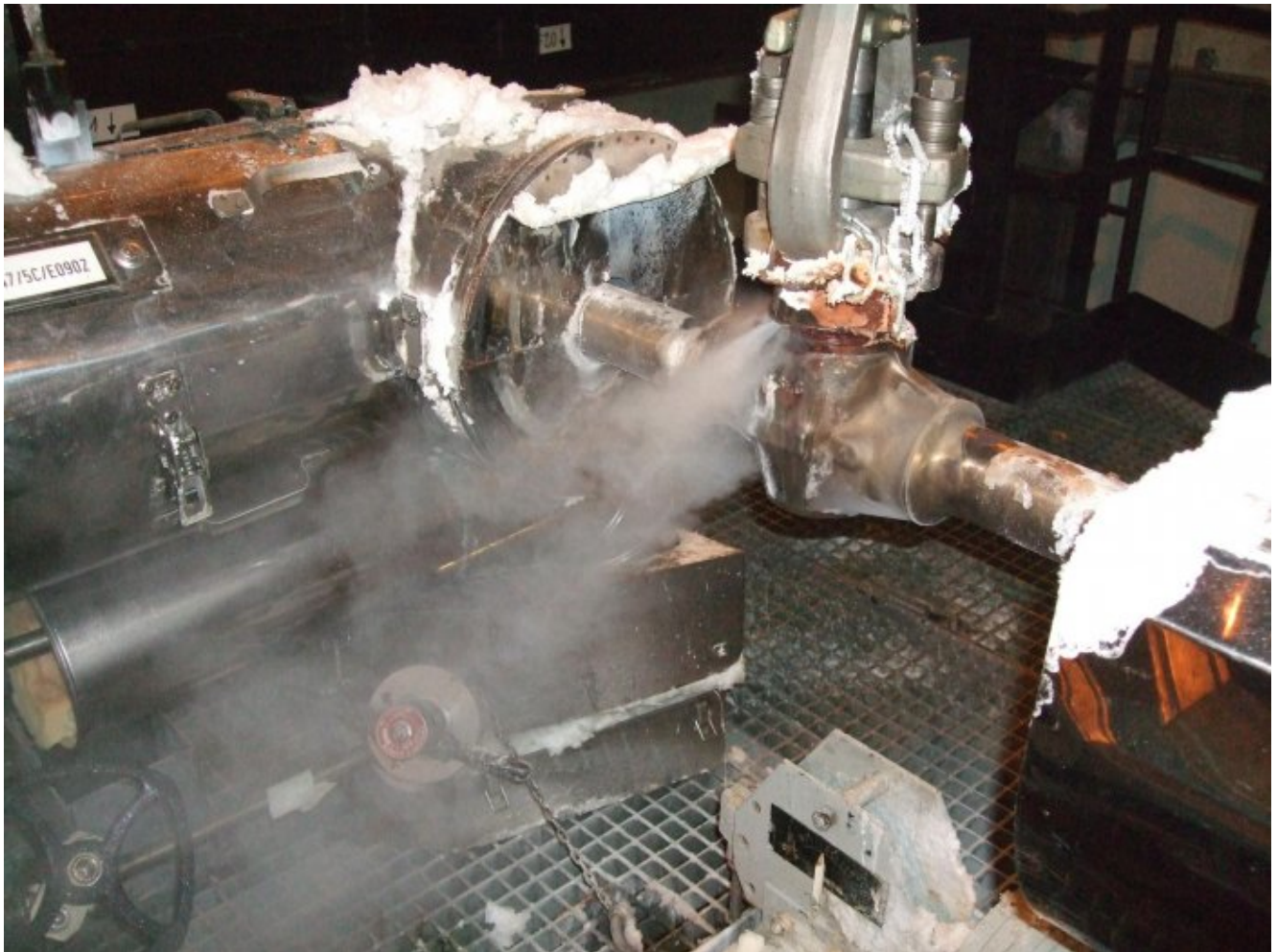
Photo : une fuite sur le circuit primaire de la centrale de Paluel en 2009 (Médiapart).
