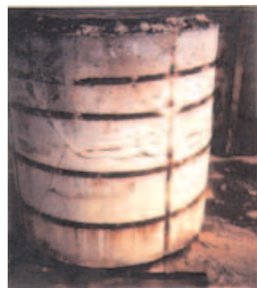
Coque béton cylindrique fissurée du CSM (Photo : ACRO)
